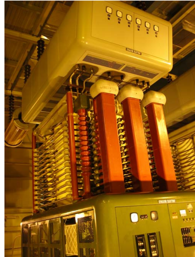
Quecksilberdampfgleichrichter der HGÜ "Nelson-River" (Sperrspannung: 150 kV, maximaler Strom: 1800 A)
